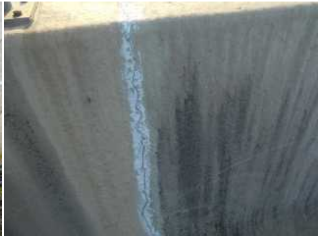
(S2) 방호벽 균열(CW=0.2/L=2.0)
