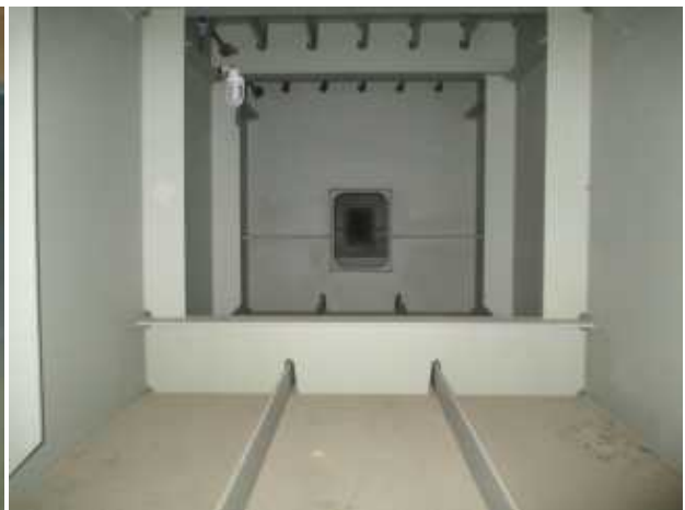
(S3 G2) S.T BOX 내부 상태양호
