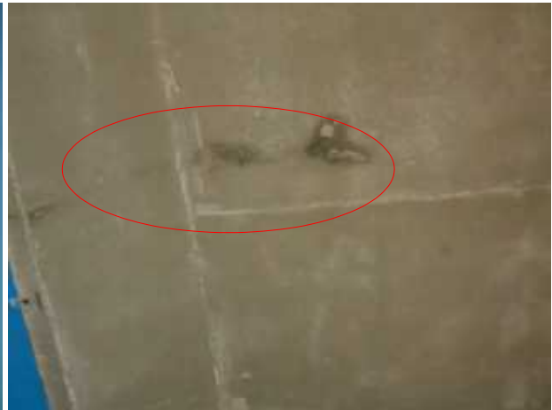
(S1) 바닥판 하면 균열 및 백태
