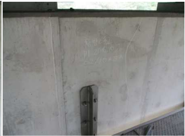
(P1) 교각 균열(CW=0.2/L=1.0)
