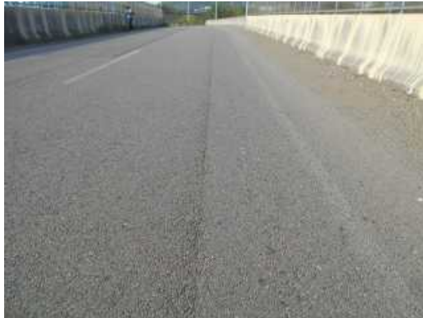
(S2) 아스콘 포장 균열
