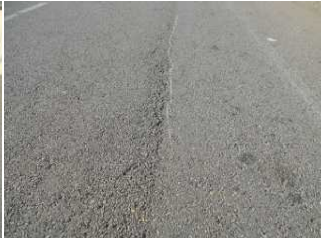
(S3) 아스콘 포장 균열
