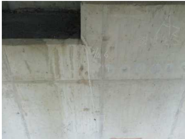
(A2) 교대 균열(CW=0.2/L=0.6)
