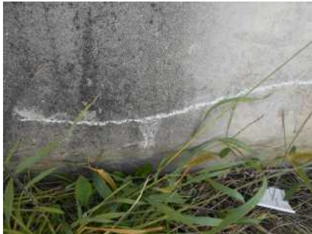
(S2) 방호벽 균열 및 백태 (CW=0.3/L=2.5)
