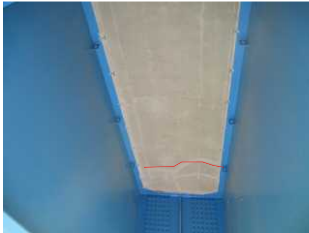
(S1) 바닥판 하면 균열(CW=0.2/L=1.0)
